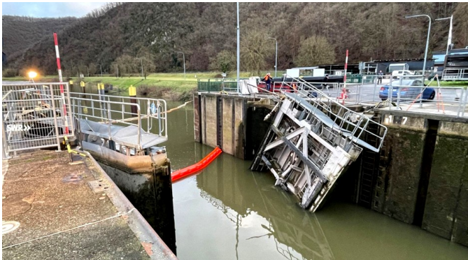
De door een op de trackpilot varende schip aangevaren sluisdeuren bij Müden, Duitsland. Foto WSA
